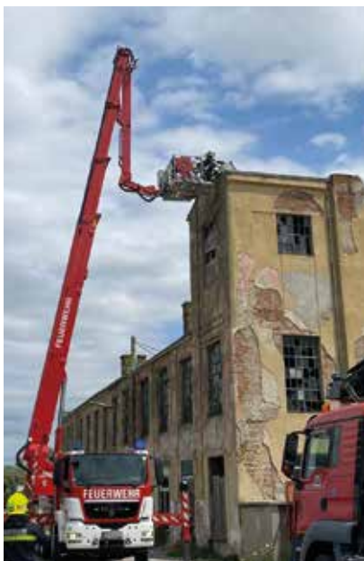
In rund 15 Meter Höhe hatte sich ein Blechdach vom Gebäude gelöst und musste geborgen werden.
