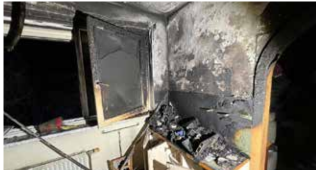
Die Brandwohnung in der Heidestraße
